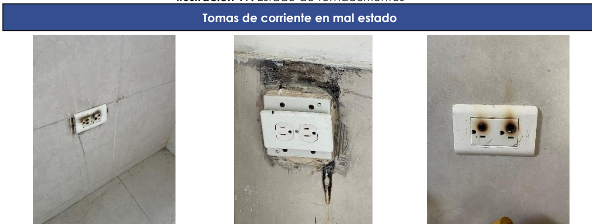
Ilustración 17. Estado de tomacorrientes
