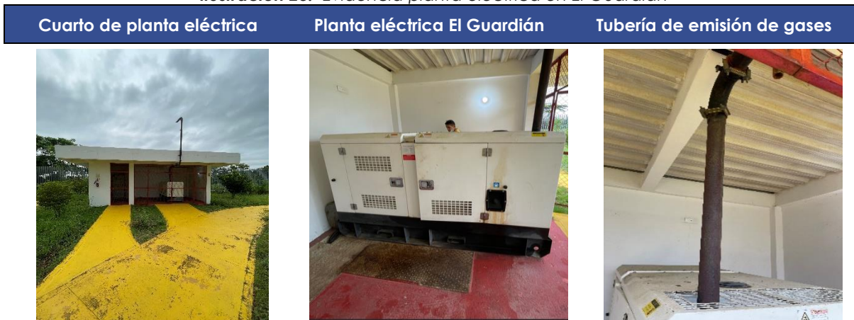
Ilustración 28. Evidencia planta eléctrica en El Guardián
